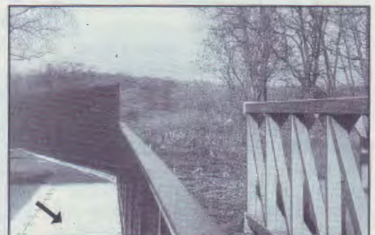
Umstrittene Gitterroste der Fußgängerbrücke am Elsterwehr
