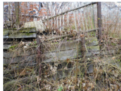
Schadstelle in der Böschung oberhalb des Bahnsteiges 1
